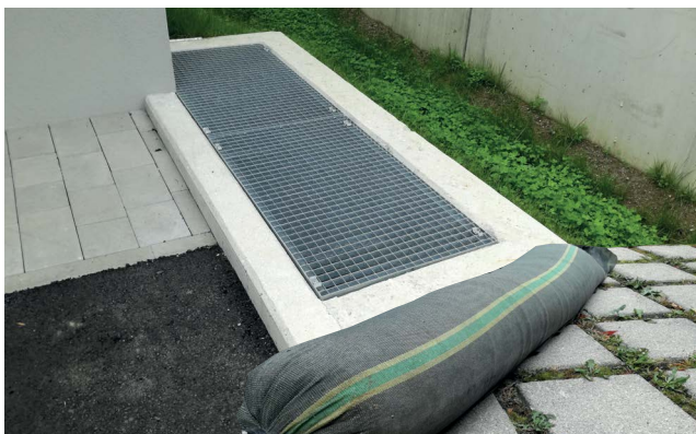
Abbildung 30: Kellerfenster mit erhöhtem Lichtschacht – zusätzlich durch Sandsack vor Wassereintritt geschützt.
