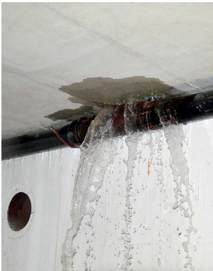
Abbildung 10: Wenn Starkregenfälle das Kanalsystem überlasten, können Schwachstellen im System oder fehlende Rückstausicherungen zu ernstesten Schäden führen.
