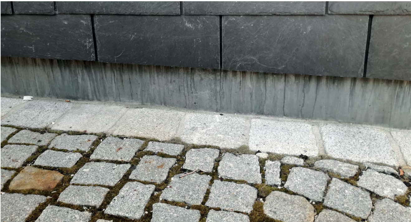
Abbildung 40: Abdichtung des gefährdeten Sockelbereichs mit Blecheinfassung. Die darüber liegenden Schieferplatten dienen als optisch ansprechende Wandverkleidung.
