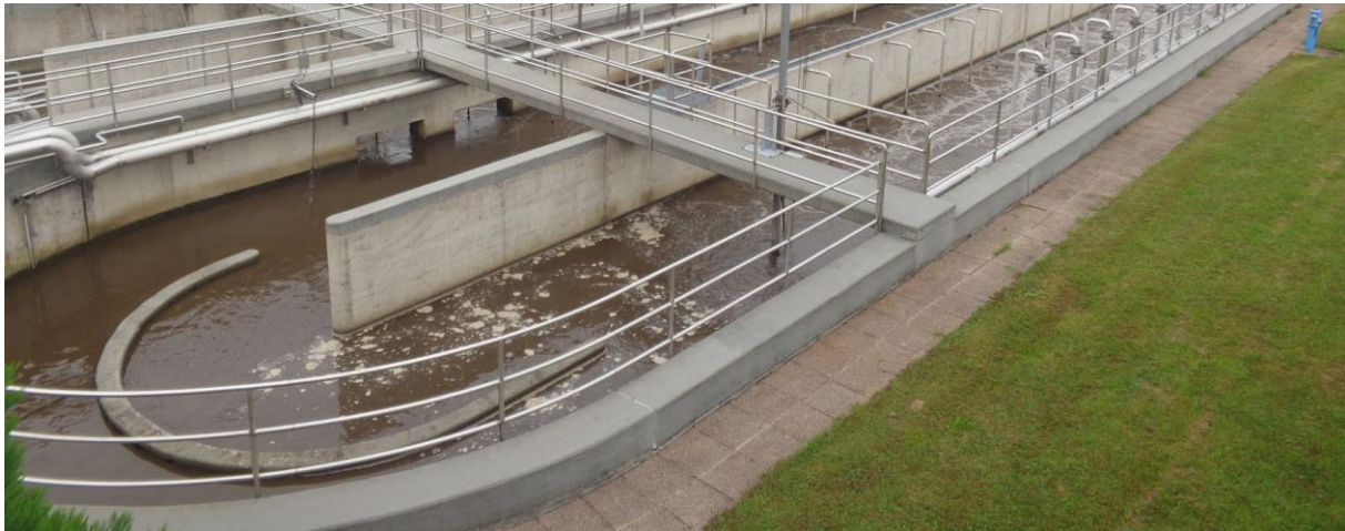
Abbildung 15: Bauliche Ausführung der Umlaufbecken Wartberg a. d. Krems
