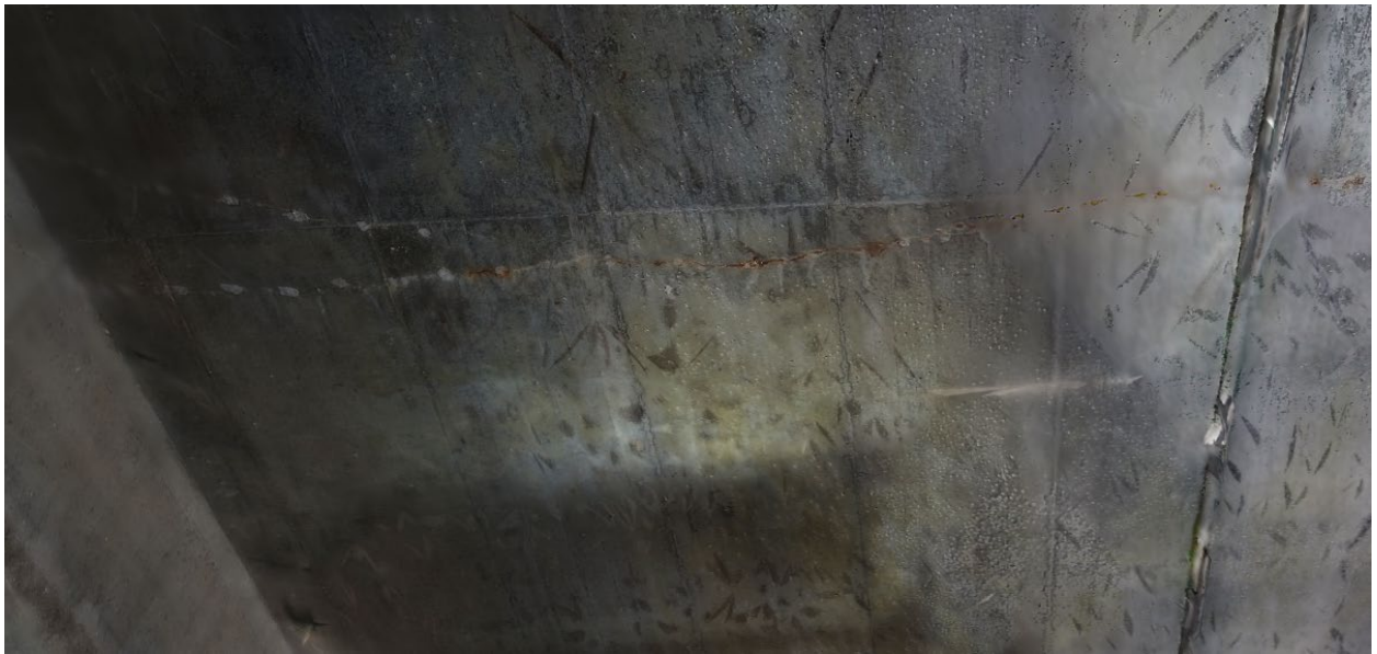
Abbildung 50: Modell SBW AWV Großsache-Nord / Riss mit Korrosion
