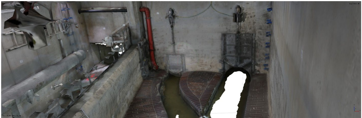
Abbildung 15: Regenüberlaufbecken IKB Innsbruck
