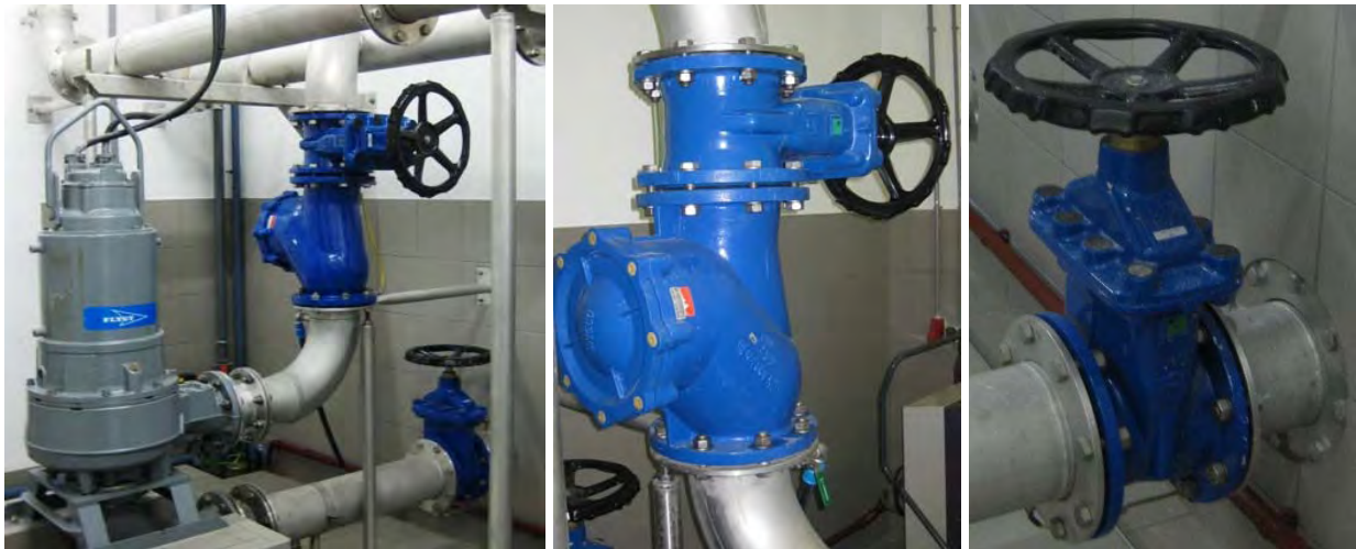
Abbildung 4-32: Armaturen in einer Pumpstation (Schitter)
