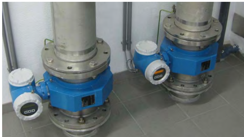
Abbildung 4-33: Magnetisch-Induktive Durchflussmessung (Schitter)
