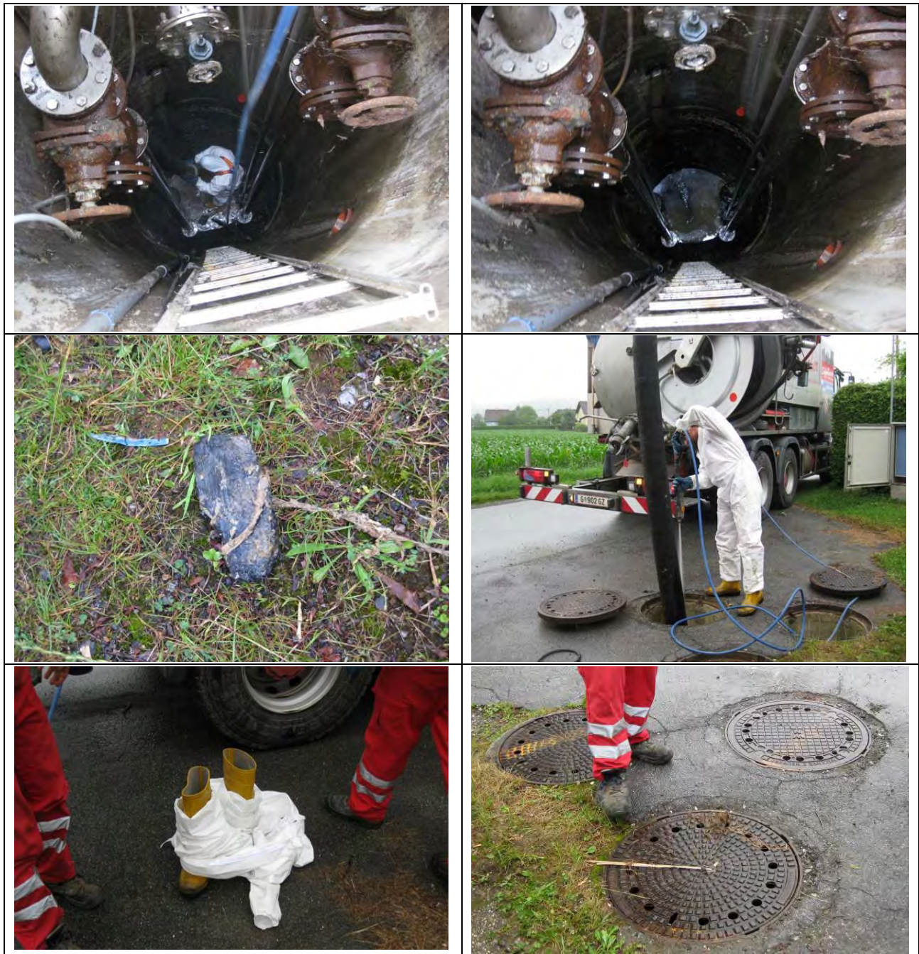
Abbildung 8-17: Foto-Dokumentation einer Pumpwerksreinigung
