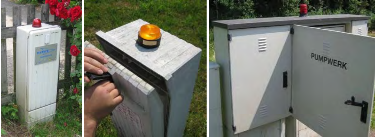
Abbildung 4-36: Drehleuchte zur Signalisierung von Störungen an Schaltkasten angebracht (Schitter)
