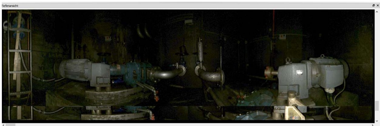
Abbildung 28: Beispiel einer CleverScan-Aufnahme – Tiefenansicht des Maschinenraums mit Motoren der Pumpen.
