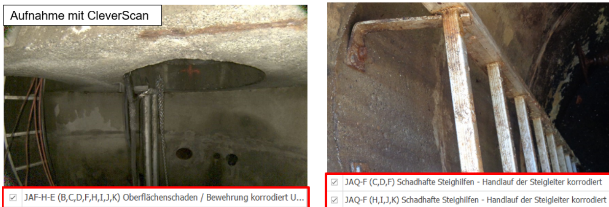
Abbildung 23: Korrodierte Bewehrung (links) und korrodierte Handlauf der Steigleiter (rechts).
