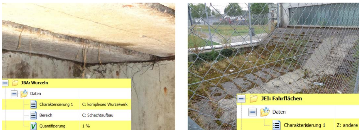
Abbildung 18: komplexer Wurzeleinwuchs (links) und Vegetation oberhalb des Unterflurbautes (rechts).
