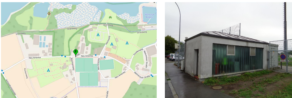
Abbildung 16: Standort des PW Neu Amerika im mSYS.Service (links) und vor-Ort (rechts).
