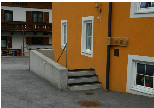
Abb. 5.7: Mittels Stufenpodest über das Hochwasserniveau gezogener Kellerabgang mit Stahlbetonschutzmauer; gegen Feststoffanprall ungeschütztes Fenster auf Straßenniveau; aus [9]
