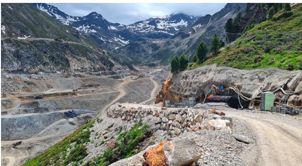
Oben: Einer der beiden Cat Hydraulikbagger 6015B Unten: Blick vom Notüberlauf in Richtung Speichersee Kühtai
